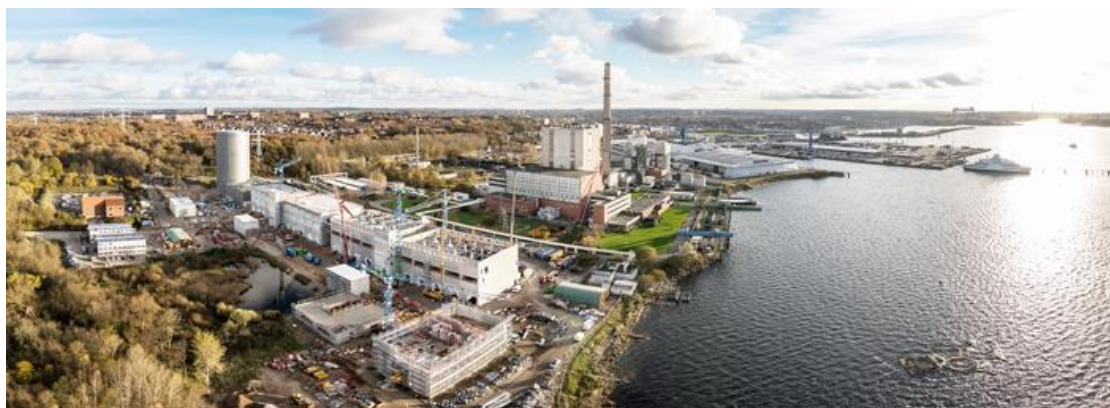
沿海发电厂的蓄热和电极锅炉 20个CHP引擎基本完成（图片：Stadtwerke Kiel）
